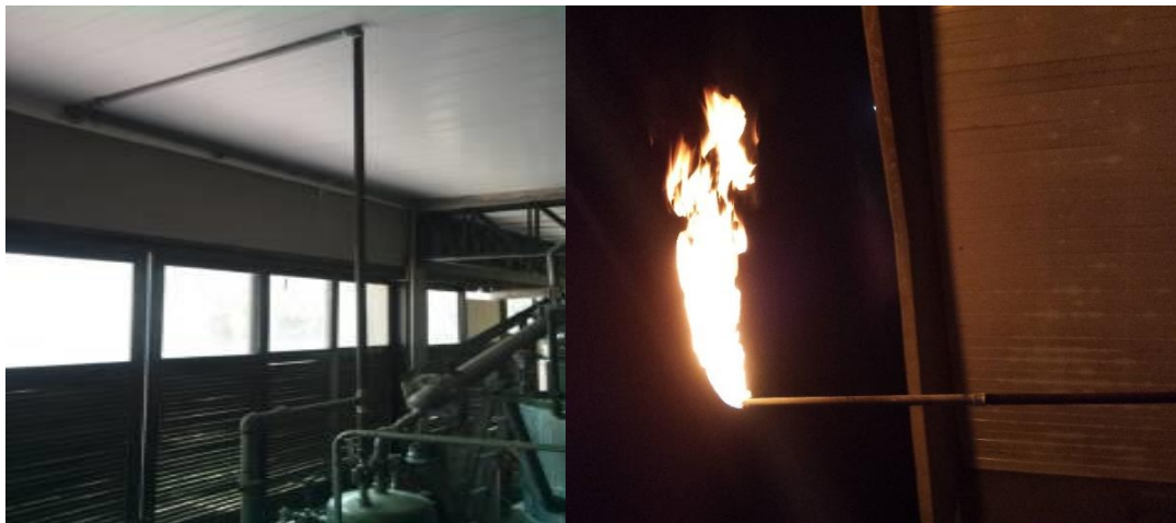
Figura 4.34: Sistema de Cogeração de Gases Residuais da Unidade Piloto. Fonte: O autor.
