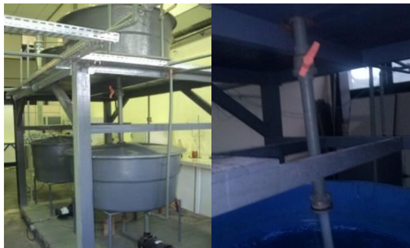
Figura 4.31: Sistema de Resfriamento da Unidade Piloto de Craqueamento.
