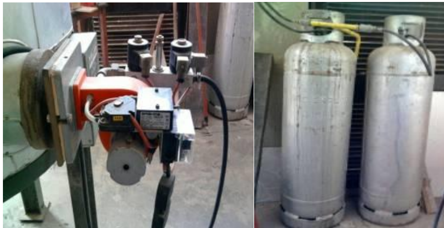
Figura 4.30: Sistema de Queima e os Cilindros de armazenamento de GLP.
