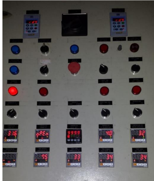
Figura 4.35: Painel do Sistema de Controle da Unidade Piloto de Craqueamento.
