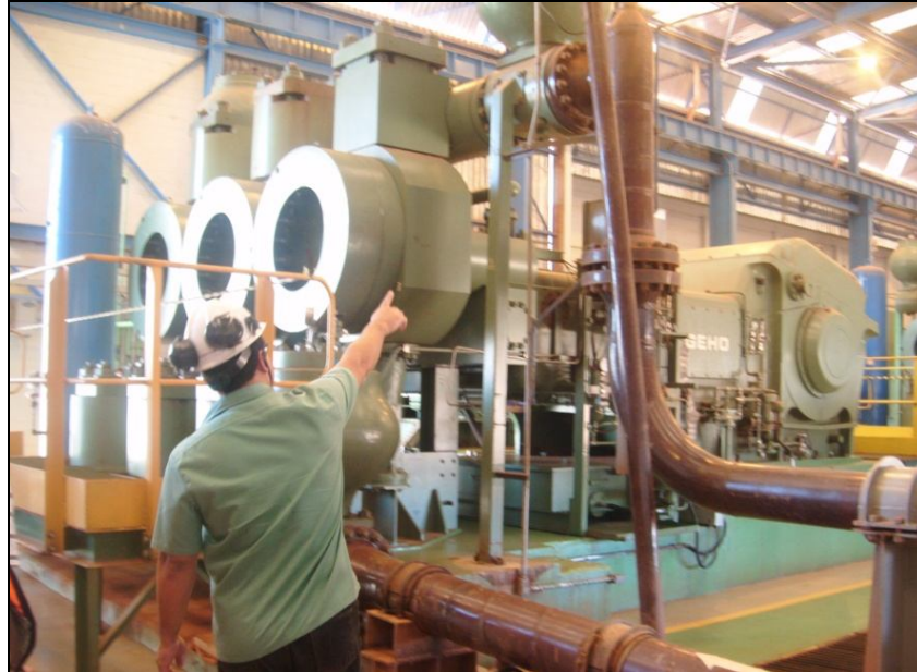
Figura 2.23: Bombas de deslocamento positivo da MBP
