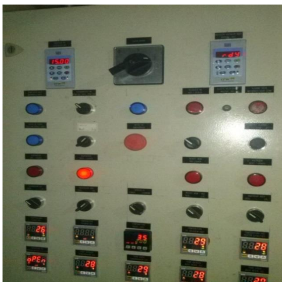
Figura 4.32- Painel do Sistema de Controle da Unidade Piloto de Craqueamento.
