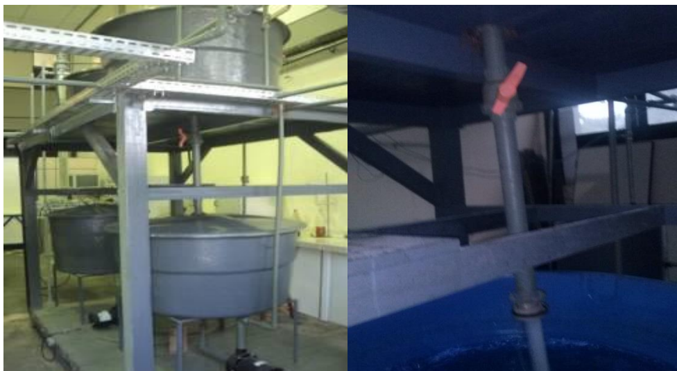
Figura 4.23- Sistema de Resfriamento da Unidade Piloto de Craqueamento.
