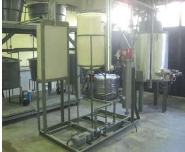
Figura 4.24- Sistema de Alimentação e Bombeamento da Unidade Piloto. Fonte: MOTA, 2013.
