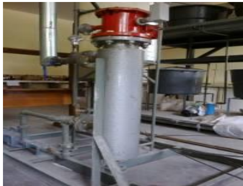
Figura 4.25- Pré-Aquecedor da Unidade Piloto de Craqueamento.
