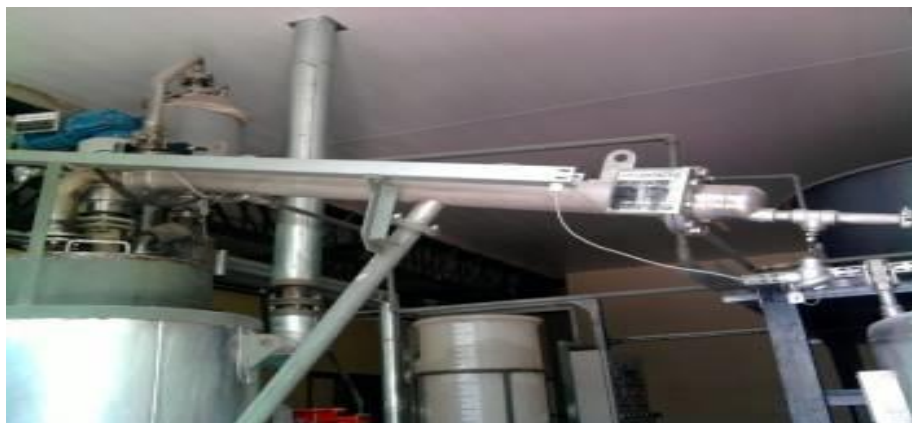
Figura 4.29- Condensador da Unidade Piloto de Craqueamento. Fonte: O autor.
