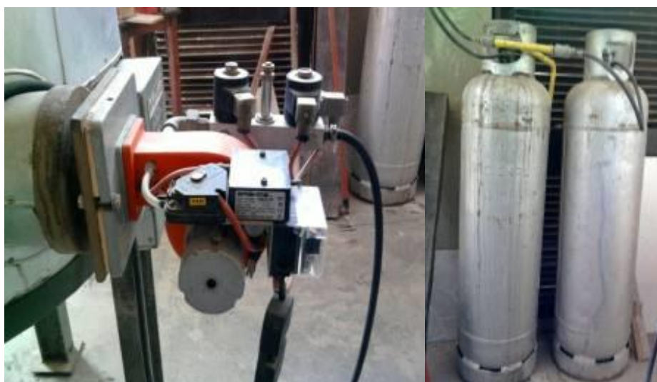
Figura 4.26- Sistema de Queima e os cilindros de armazenamento de GLP. Fonte: MOTA, 2013.
